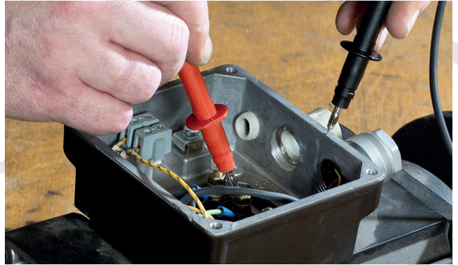
Sondes de test pour trouver des défauts au châssis et des défauts entre phases.
